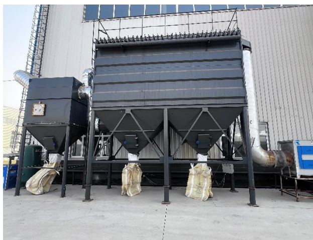
极冷设施、5# 布袋除尘器
