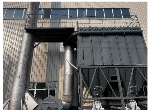
锌合金废气治理设施检测平台
