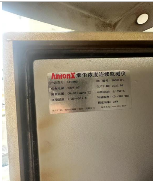
再生熔炼炉气在线监测设备（烟尘）
