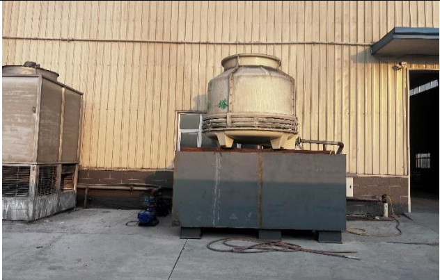
4# 电炉冷却设备（开放式冷却塔+循环水池）
