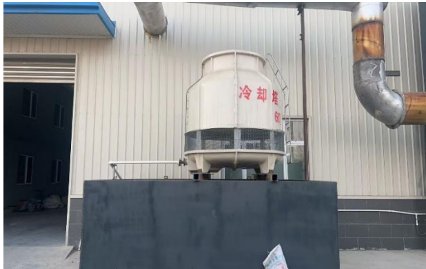
1# 电炉冷却设备（开放式冷却塔+循环水池）
