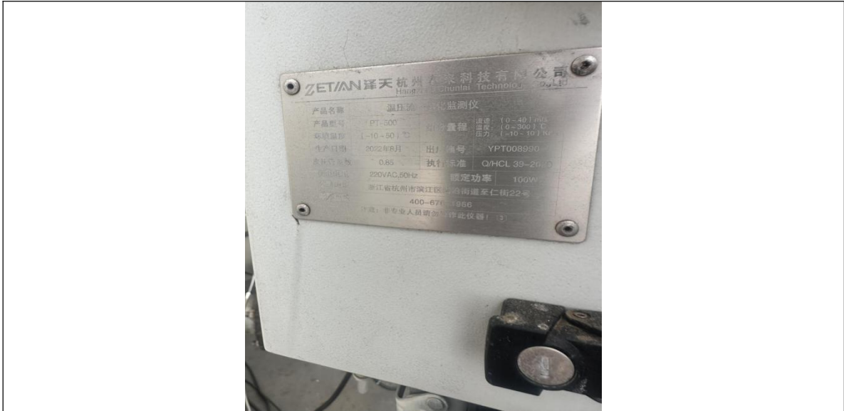
再生熔炼炉气在线监测设备（温压、流量）
