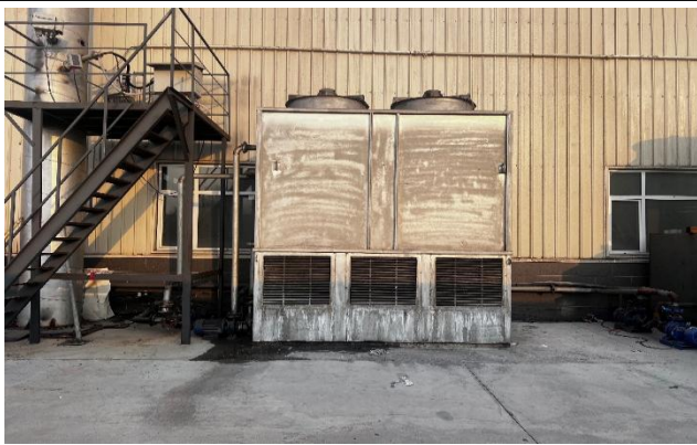
2# 电炉冷却设备（闭式冷却塔）
